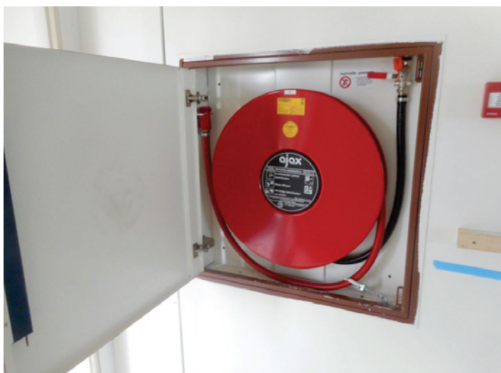
Figuur 5: Brandslanghaspelkast in 'brandwerende' scheidingswand
